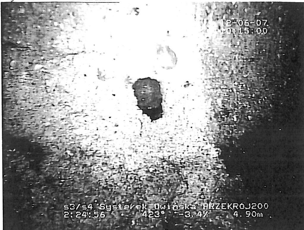
Zdj nr 11- uszkodzona rura
