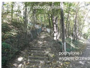
Fot.31 Stoki osuwiska w Starym Puszczykowie
