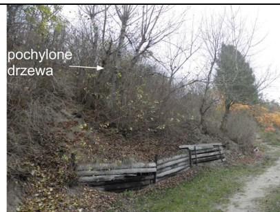
Fot.64 Stok osuwiska Radzewicach z prowizorycznymi wzmocnieniami oporowymi
