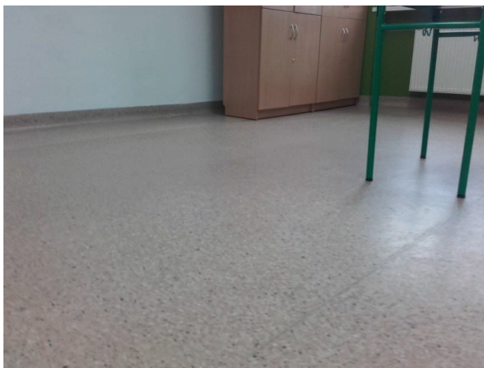
Fot. 12. Widoczna obniżenie posadzki w narożniku północno-zachodnim
