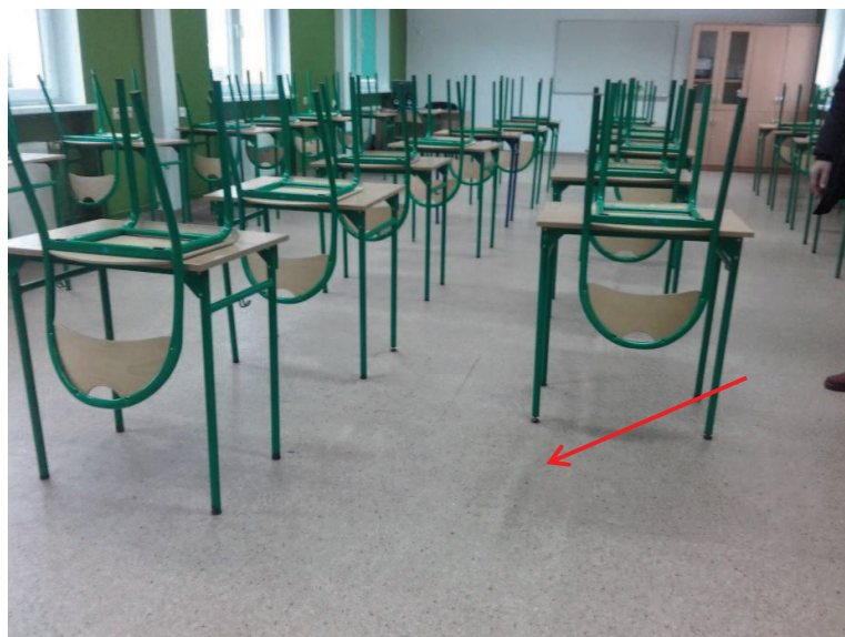
Fot. 7. Widok ogólny na wnętrze sali lekcyjnej z widocznym wybruszeniem wykładziny
