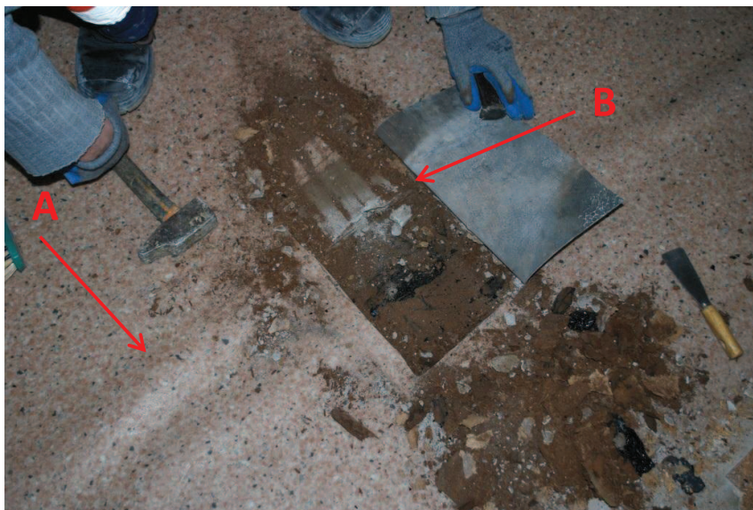
Fot. 8. Podłużne wybrzuszenia wykładziny oraz odkrywka nr 2 w miejscu uszkodzeń.
