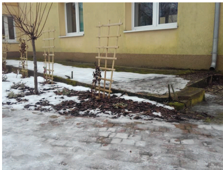
Fot. 15. Zawilgocenie elewacji od strony północnej, widoczne osiadanie tarasu betonowego od strony północno-zachodniej.
