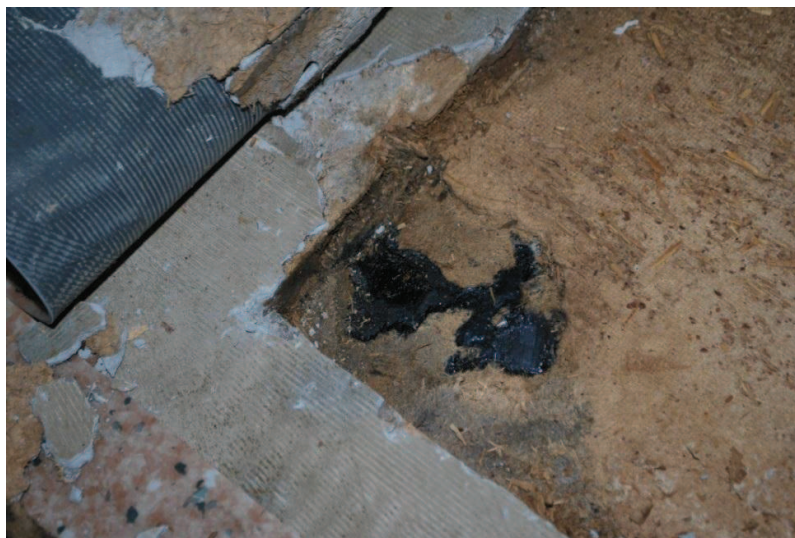
Fot. 11. Widoczna woda na izolacji przeciwwilgociowej w miejscu odkrywki nr 2.
