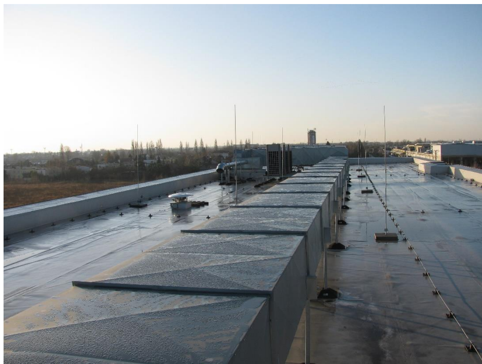
Dach – instalacja wentylacji i chłodzenia
