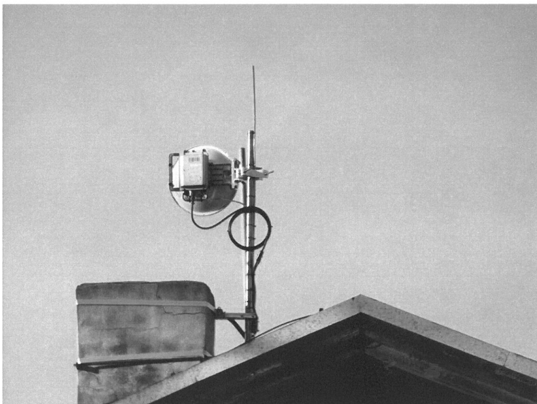
Widok instalacji radiokomunikacyjnej Stacja Netia KORNB053 - KORNM00046ANT001; Gądkki, ul. Dworcowa, działka nr D59/9 obręb Gądkki .
