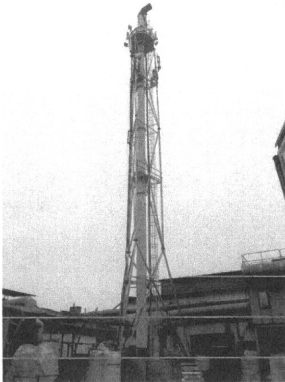
Zal. nr 1: Widok ogólny instalacji radiokomunikacyjnej.
