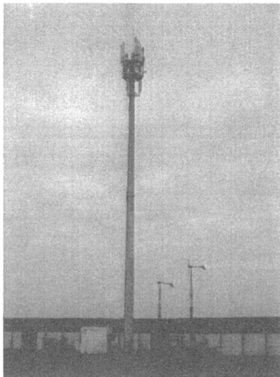
Zal. nr 1: Widok ogólny instalacji radiokomunikacyjnej.
