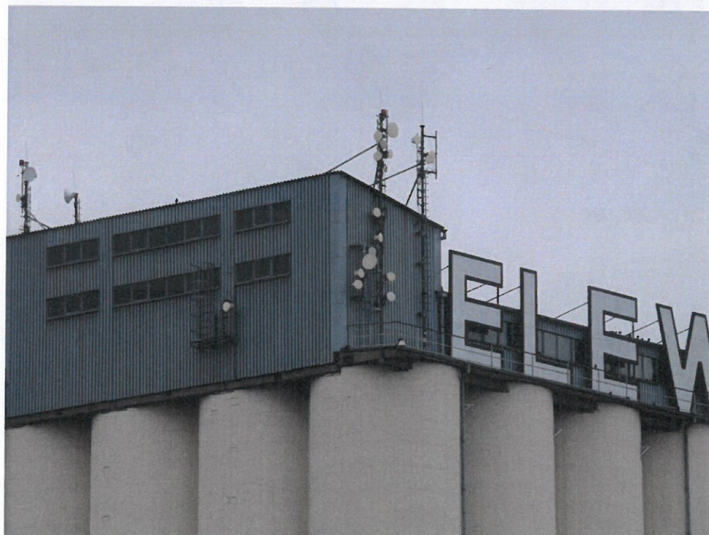
Widok instalacji radiokomunikacyjnej Stacja Netia KORNT001 - KORNM00001 Gądki, ul. Zbożowa 1.
