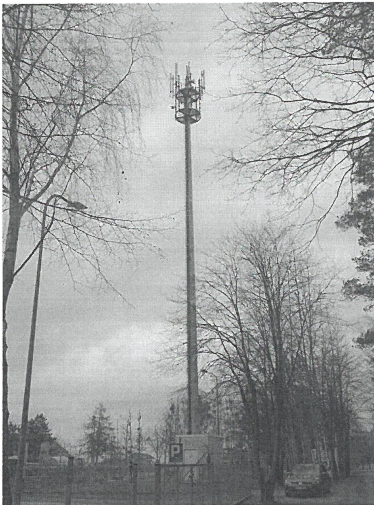
Zal. nr 1: Widok ogólny instalacji radiokomunikacyjnej.
