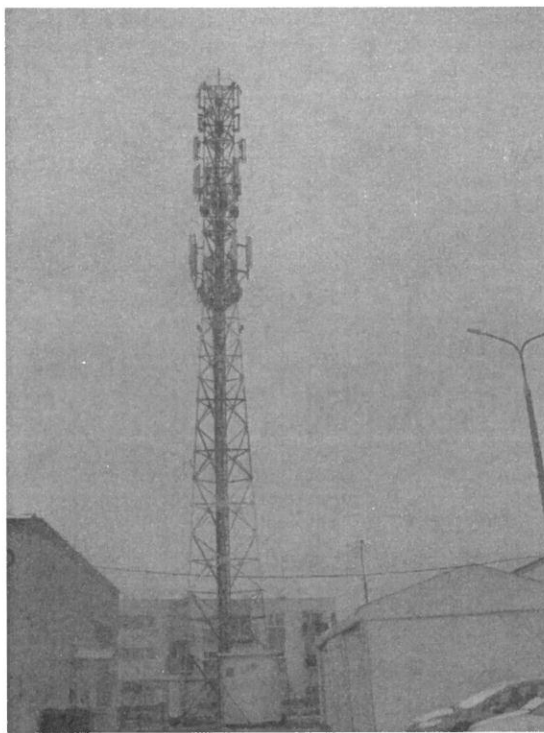
Zał. nr 1: Widok ogólny instalacji radiokomunikacyjnej.
