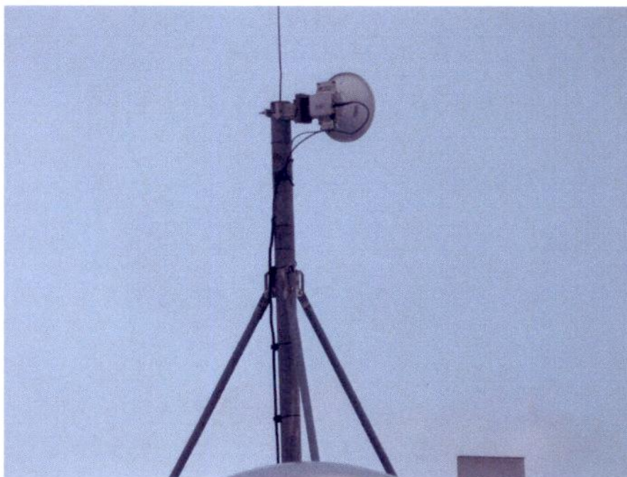
Widok instalacji radiokomunikacyjnej Stacja Netia LBONR001 - LBONM00008 Luboń, ul. Dębiecka 1.
