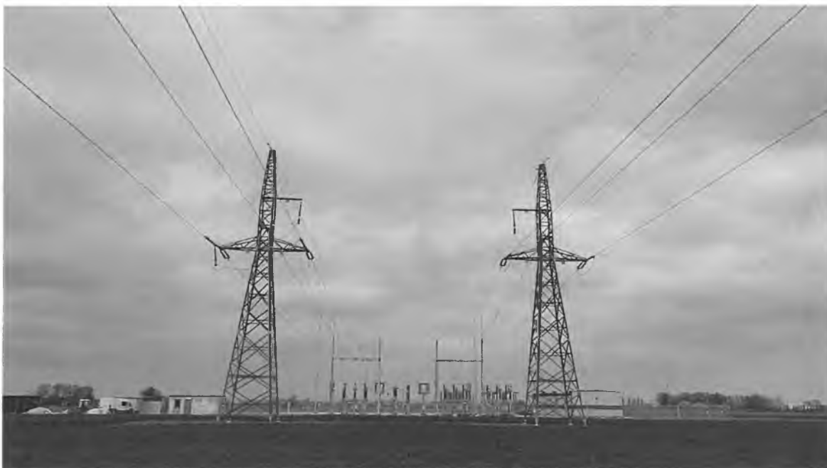
Zdjęcie nr 1. Przęsło słup nr 31 – bramka dla LWN 110 kV Swarzędz – Kostrzyn (lewa strona) oraz przęsło bramka - słup nr 1 dla LWN 110 kV Kostrzyn – Nekla (prawa strona) - widok fragmentu obiektu.
