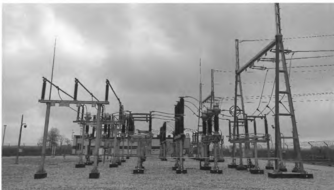
Zdjęcie nr 2. Rozdzielnia sieciowa 110 kV RS Kostrzyn Wielkopolski- widok fragmentu obiektu.
