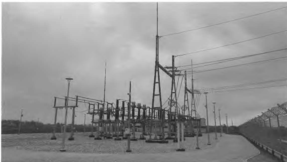
Zdjęcie nr 1. Rozdzielnia sieciowa 110 kV RS Kostrzyn Wielkopolski- widok fragmentu obiektu.
