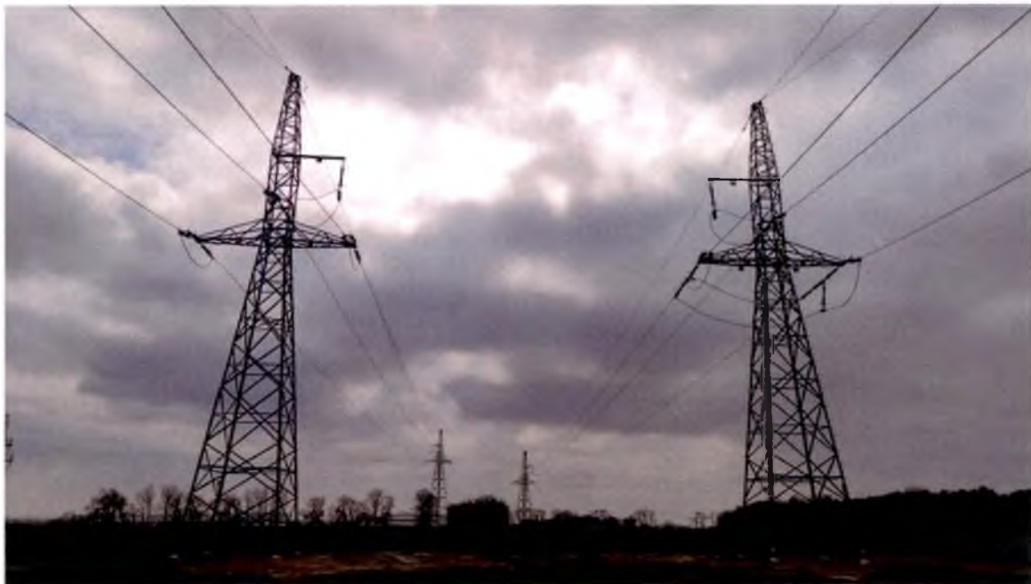
Zdjęcie nr 2. Przęsło słup nr 1 – słup nr 2 dla LWN 110 kV Kostrzyn – Nekla (lewa strona) oraz przęsło słup nr 30 - słup nr 31 dla LWN 110 kV Swarzędz – Kostrzyn (prawa strona) - widok fragmentu obiektu.
